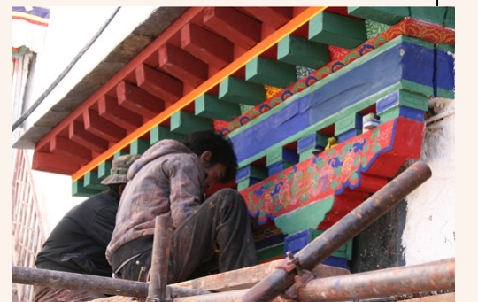
Các công nhân xây dựng đang sửa chữa Tu viện Drepung - Photo: Xinhua
